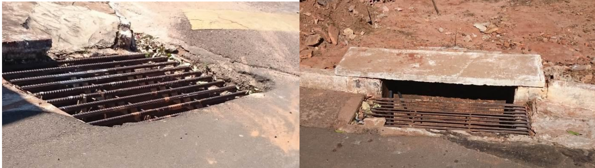
Figuras 60 e 61 – Bocas de lobo.
