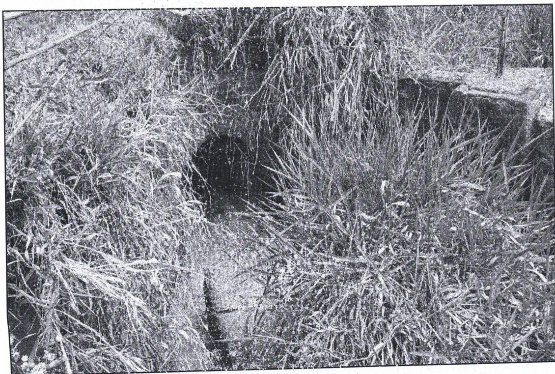
Figura 6 -- Lançamento atual existente com tubulação de diâmetro inferior ao necessário, em local irregular, causando o início de processos erosivos no local.
