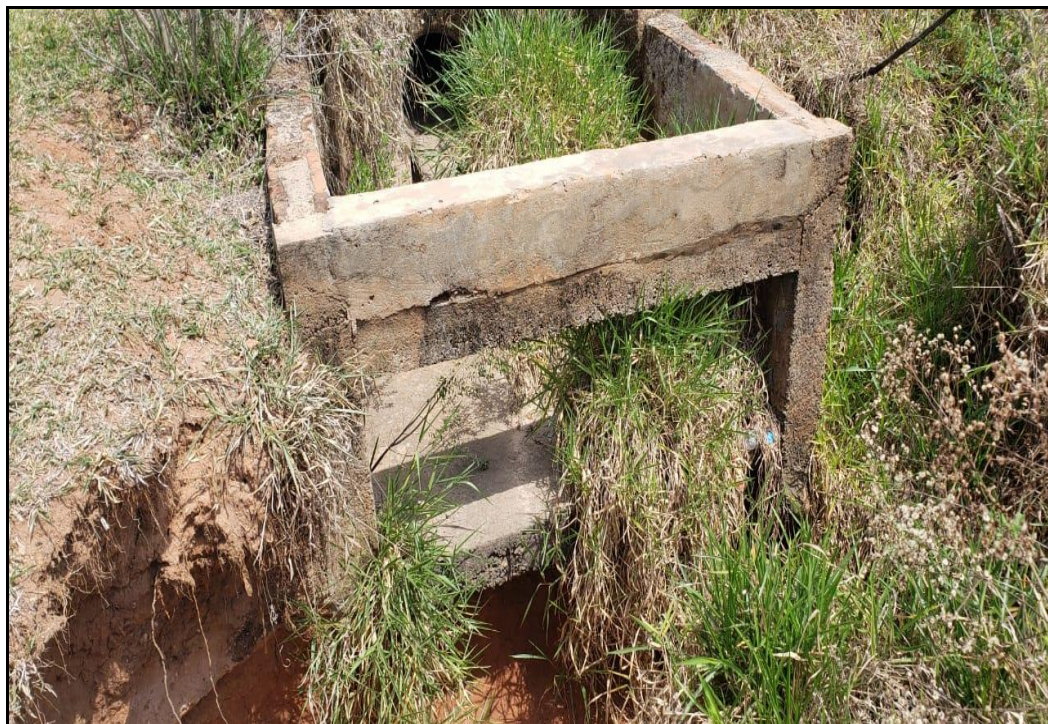
Figura 1 – Estrutura existente danificada próximo ao lançamento inadequado das galerias de águas pluviais da bacia de contribuição, com solapamento da estrutura.
